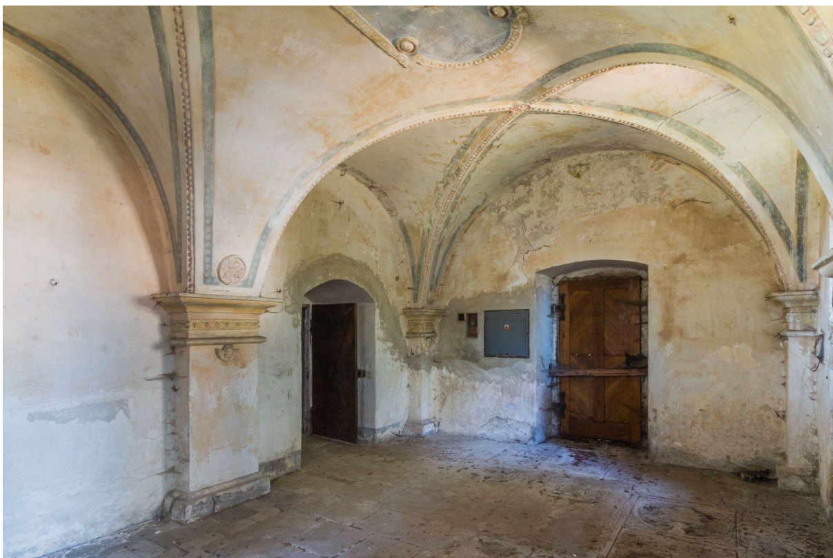
Obr. 39 Jindřichův Hradec, kostel Nejsvětější Trojice, necitlivé druhotné zásahy v okolí elektroinstalace, přemalby a rozsáhlá poškození povrchových vrstev, foto: Vojtěch Krajíček.
