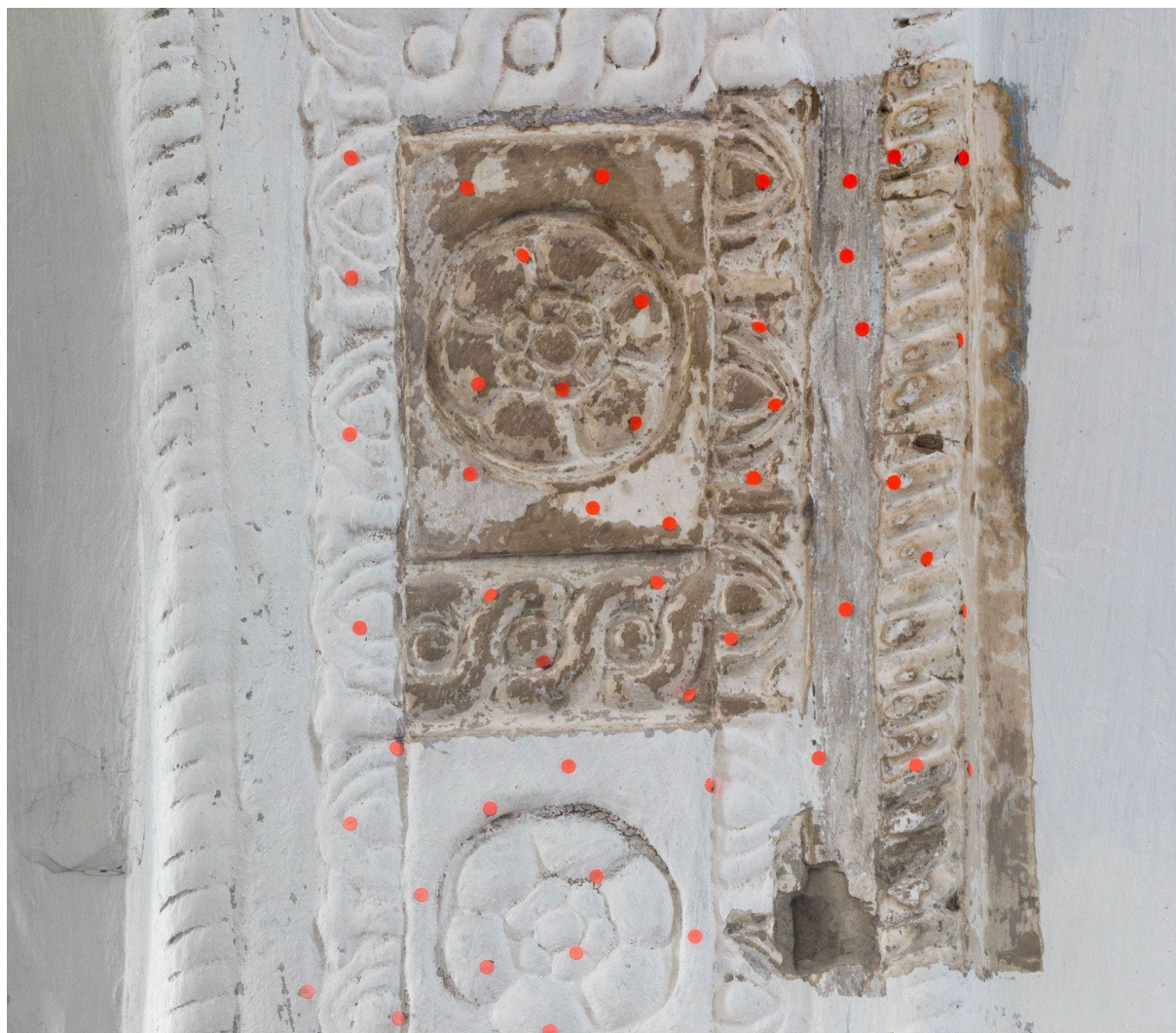
Obr. 11 Kostel sv. Michaela, Polička, identifikace armatur (kovových hřebíčků) pomocí detektoru kovu, foto: Vojtěch Krajíček.
