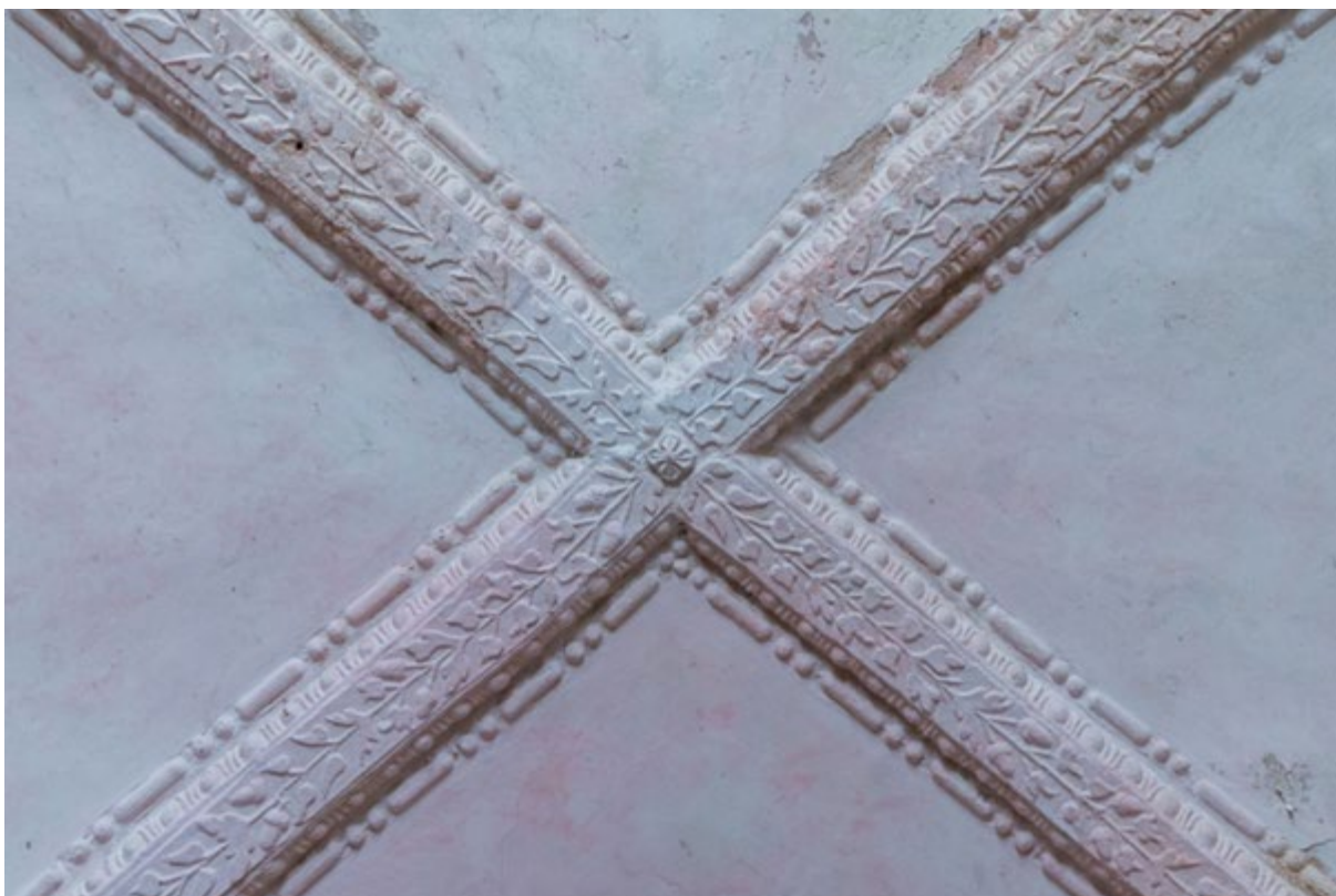
Obr. 48 Dešná, kostel sv. Jana Křtitele, křížení klenebních pásů předsíně, foto: Vojtěch Krajíček.
