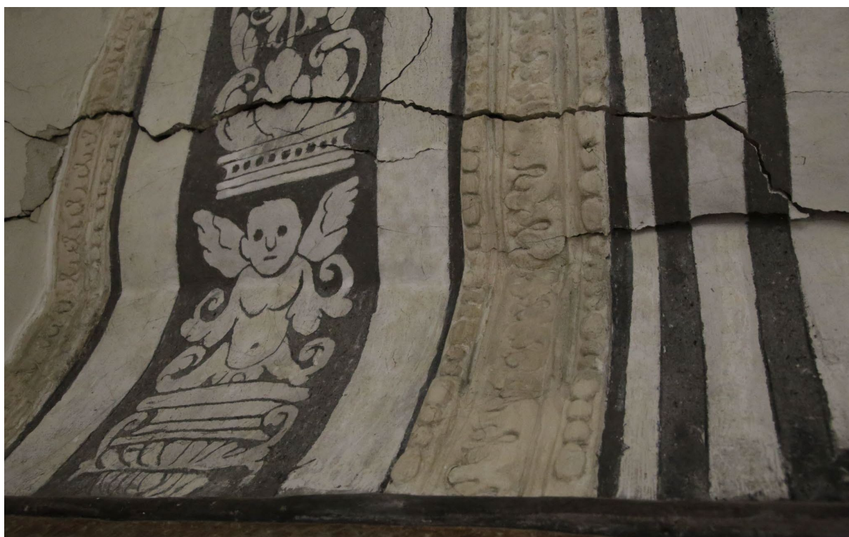
Obr. 38 Brandýs nad Labem, zámek, statické poškození klenby tzv. Rudolfova sálu, foto: Zdeněk Kovářik.
