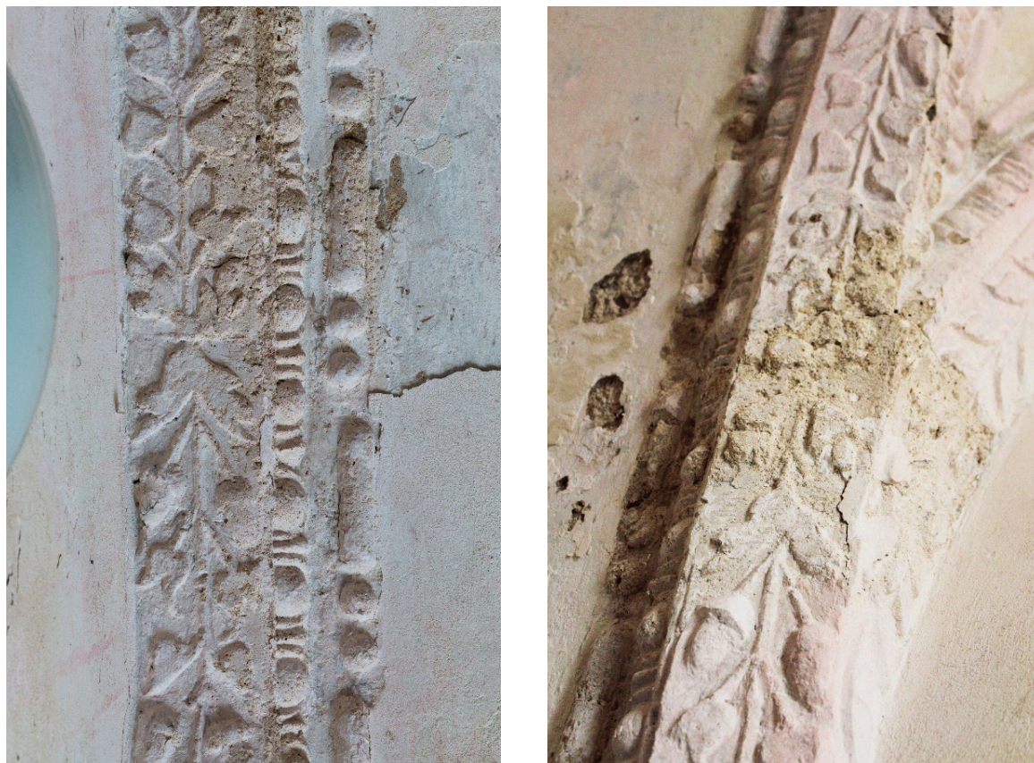
Obr. 65 Dešná, kostel sv. Jana Křtitele, předsíň, detail poškození povrchu štukového ornamentu způsobené zatékáním a působením vodorozpustných solí, foto: Vojtěch Krajíček, Zdeněk Kovářík.
