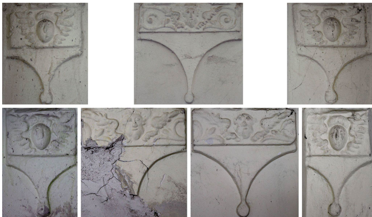
Obr. 19 Hostěradice, stará radnice, dokumentace stavu konzol klenebních pásů s otiskovanou figurální výzdobou, foto: Zdeněk Kovářík.
