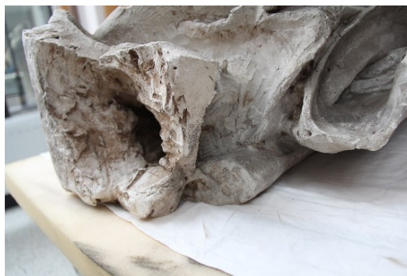
Obr. 21: Mechanické poškození plintu sochy.
