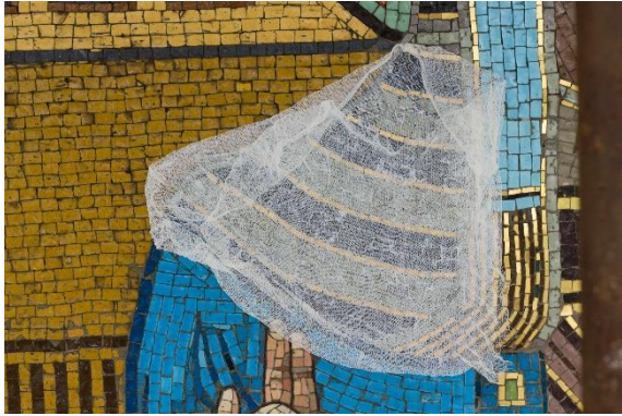
Ukázka zásahu – zajištění uvolněné oblasti ochranným přeplem.
