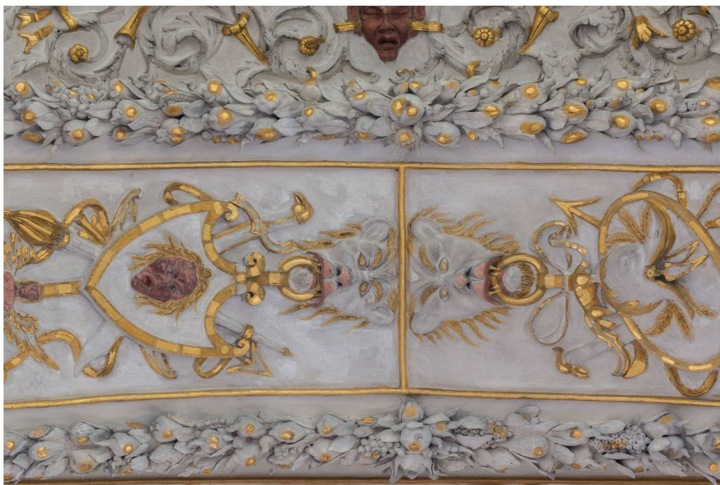
Obr. 12: Kaple Věch svatých, SZ Telč. Detail zlacené ťtukové dekorace, současný stav po opravě v 80. letech 20. století. Novodobá rekonstrukce zlacení následuje původní rozsah. Charakter opravy je oproti originálu odlišný – nově pozlacené plochy jsou příliš ostře ohraničené, při výstavbě vrstev se nepracuje s okrovou podmalbou. Foto: V. Krajíček.
