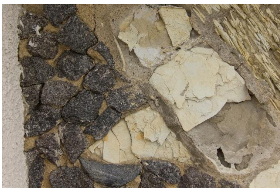
Detail levé horní části mozaiky. Stav před restaurováním – degradované opukové kameny.
