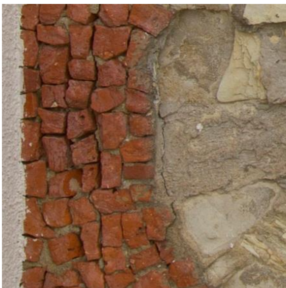
Obr. 15: Detail mozaiky Ptačí rodina – oblast s úbytkem osazovací malty ve spárách. Stav před restaurováním.
