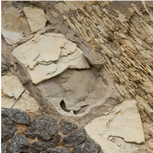
Obr. 2: Detail mozaiky Ptačí rodina – poškození, respektive ztráta opukových kamenů.
