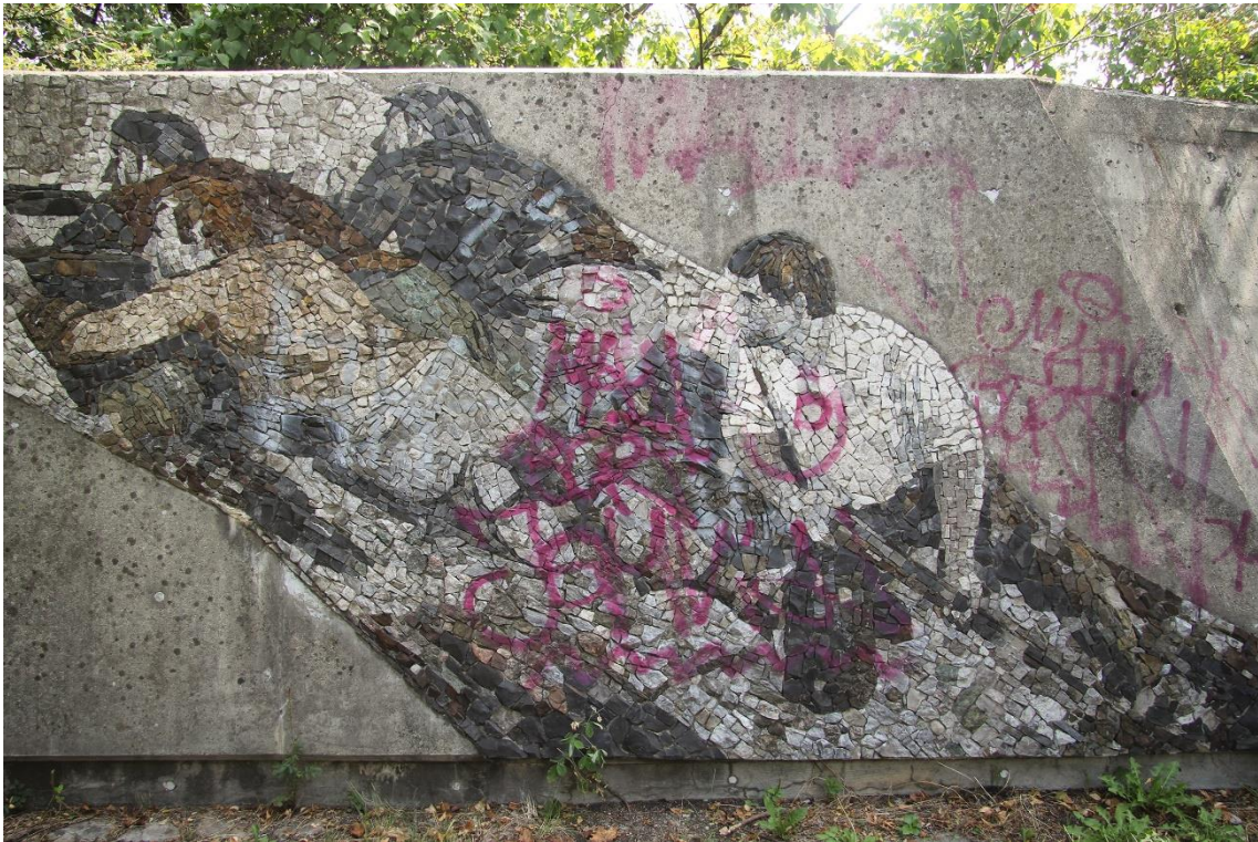
Bližší pohled na plochu mozaiky M. Sladkého. Stav před restaurováním.
