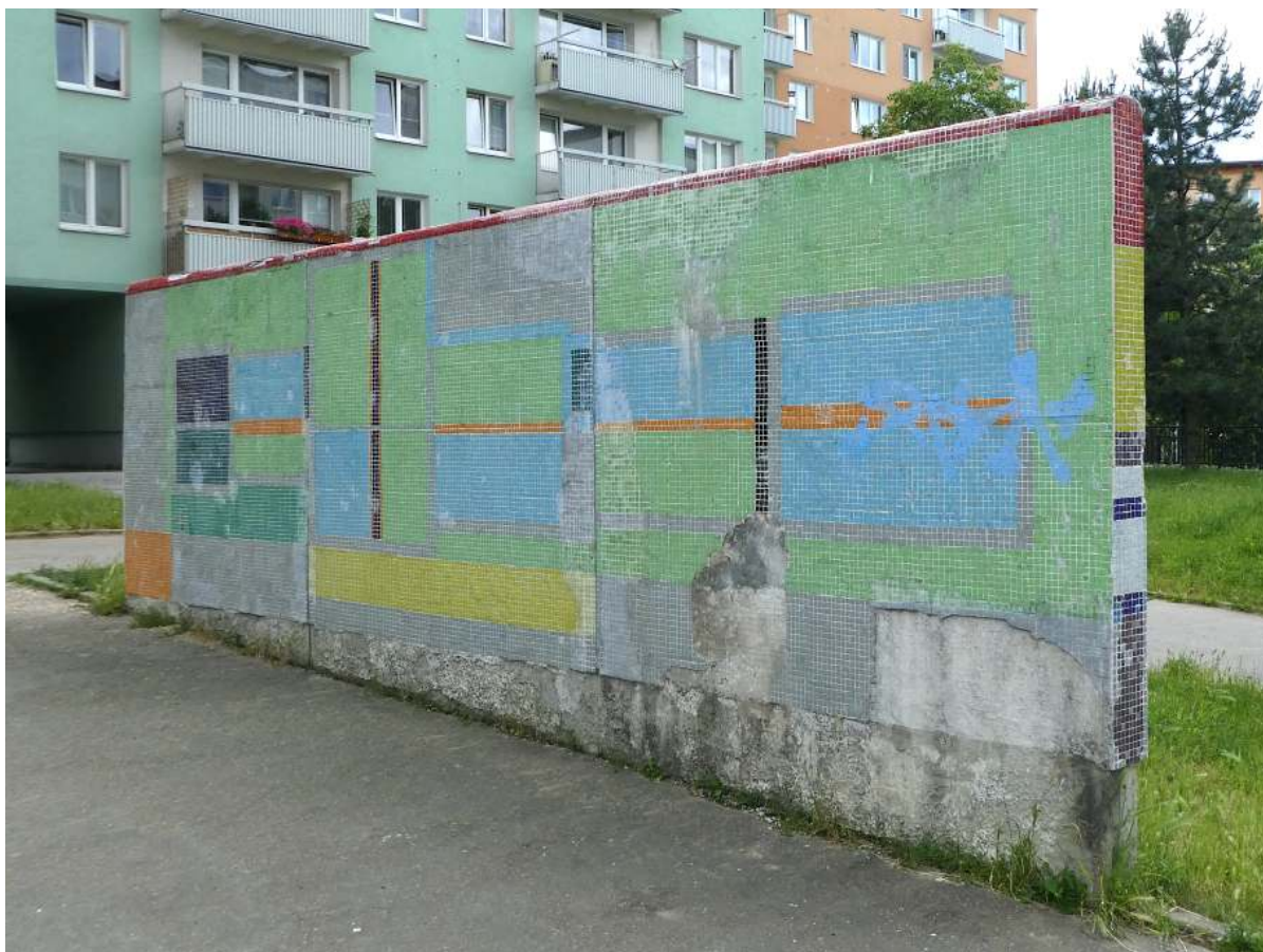
Obr. 21 Mozaika „Přítomnost člověka“ B. Matala – severní stěna, stav před restaurováním. Foto Z. Křenková
