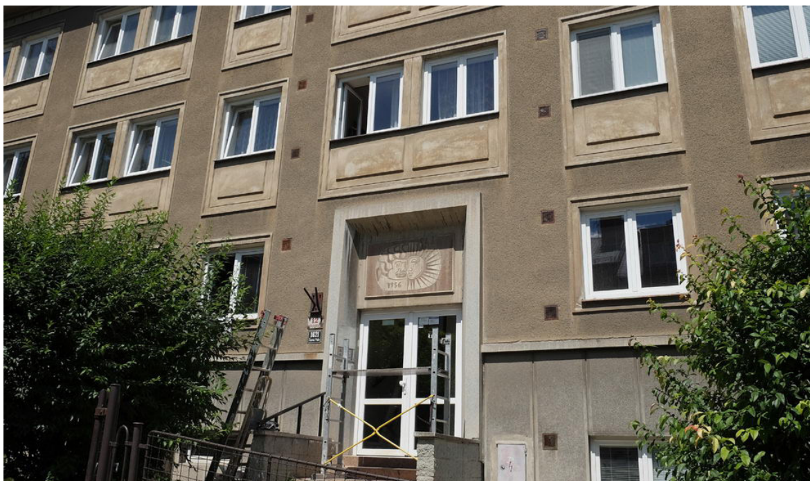
Obr. 6: Brno, Venhudova ulice. Celkový pohled na umístění sgrafita nad vstupem do domu
