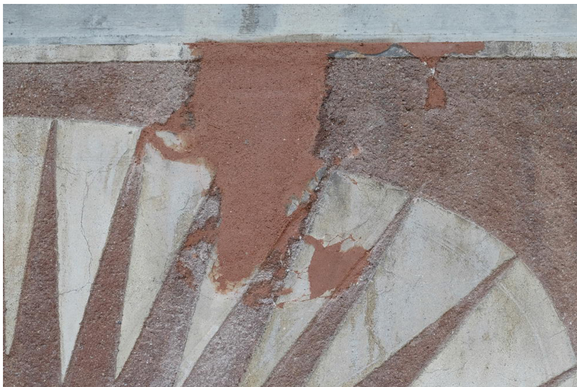
Obr. 17: Brno, Venhudova ulice. Defekt v omítkové vrstvě po vytmelení
