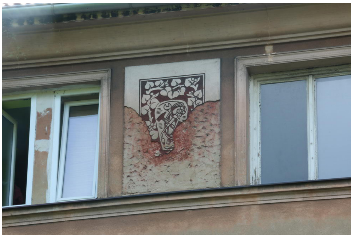
Obr. 2: Opava, Zápala ulice. Velká část omítky se sgrafitovým motivem se uvolnila od podkladu a odpadla
