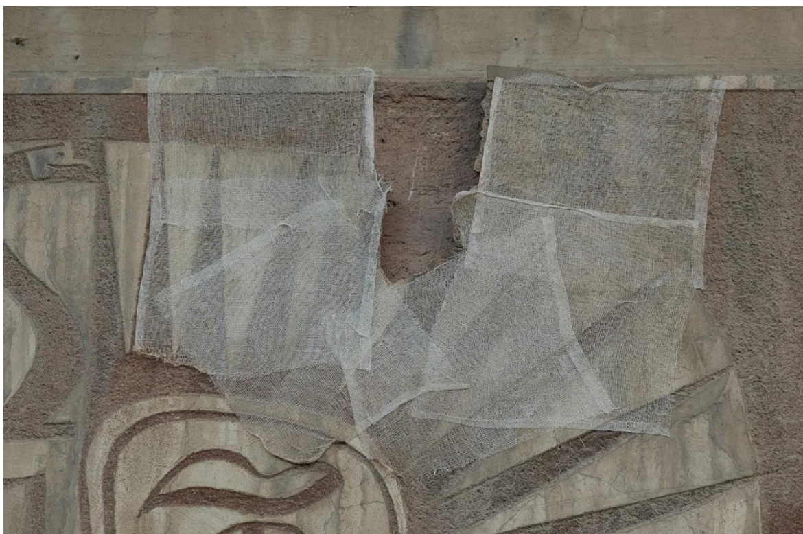
Obr. 16: Brno, Venhudova ulice. Lokální přelep odlupujících se omítkových vrstev před jejich přichycením k podložce
