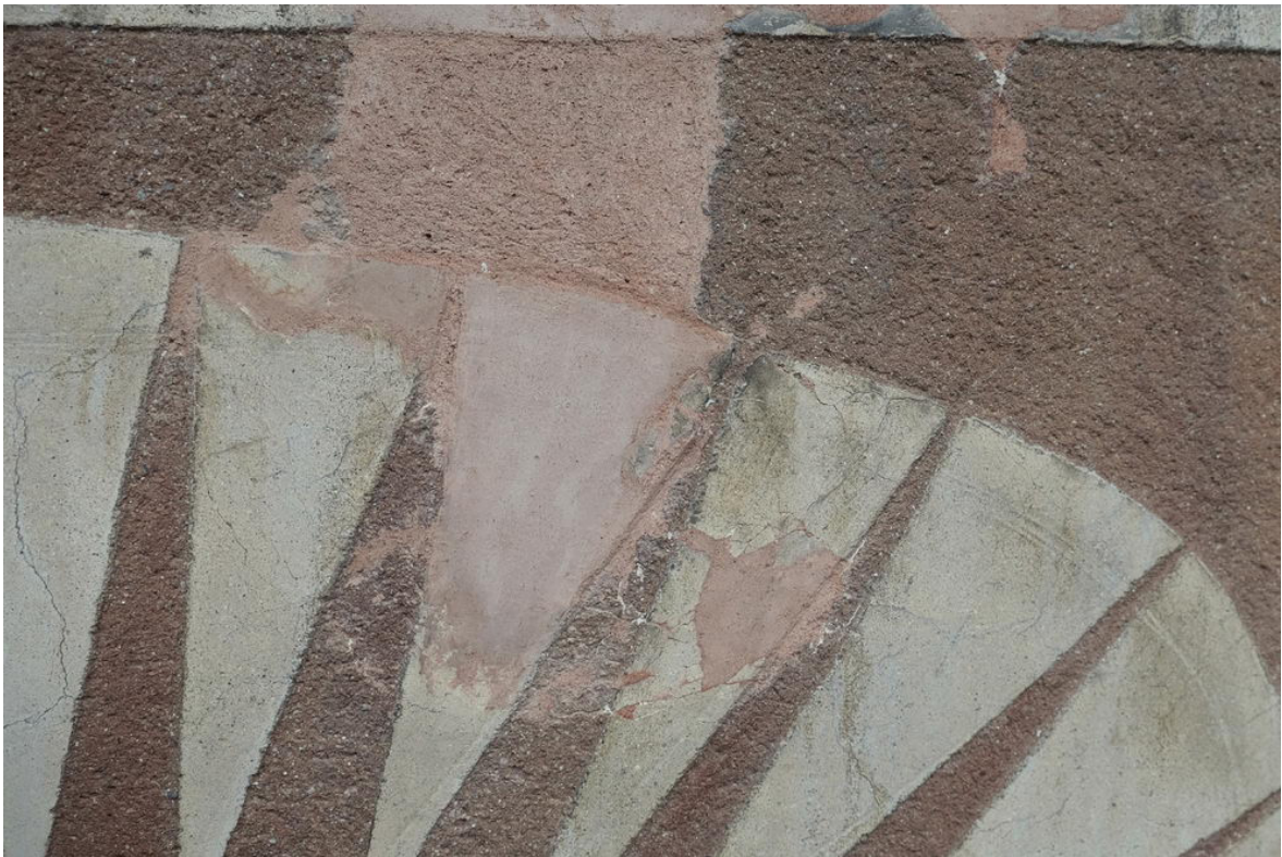
Obr. 18: Brno, Venhudova ulice. Vytmelený defekt po vytvrdnutí tmelu a povrchové úpravě (kletování a vyškrabání chybějící části motivu)
