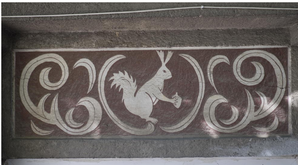
Obr. 10: Brno, MŠ Tučkova. Veverka – jeden z výjevů nad okny, stav před restaurováním
