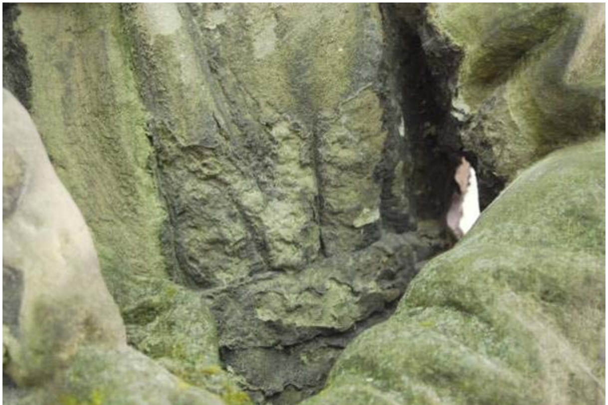
Stav před restaurováním, detail sádrovcových krust o různé intenzitě.
