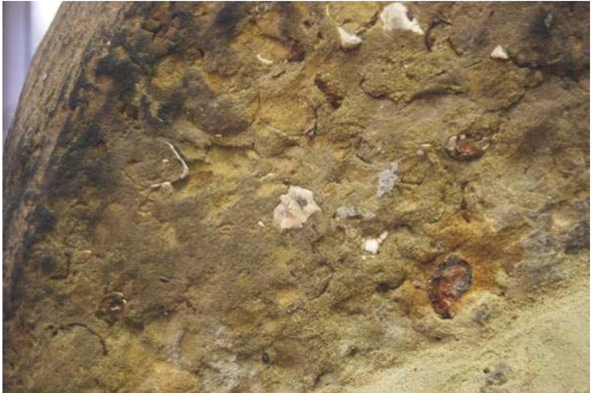
Disfoliace materiálu, různorodé složení horniny způsobující korozi
