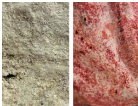
Obr. 1 Zpráškovatělý povrch, vlevo sádra, vpravo barevná vrstva. Foto: Petra Zítková
