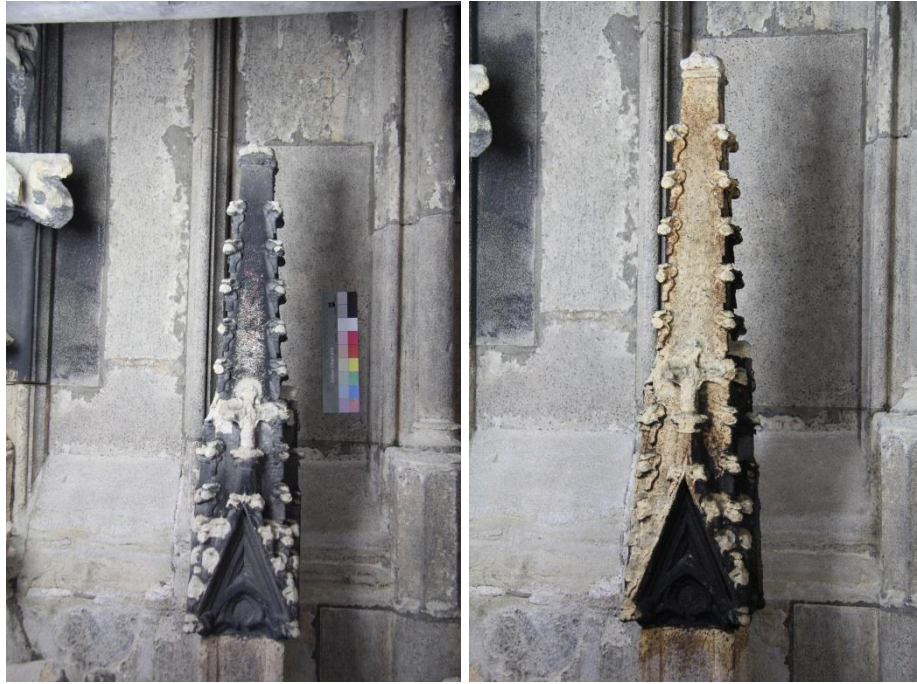
obr. 3 Čištěná fiála na fasádě St. Stephansdomu.
