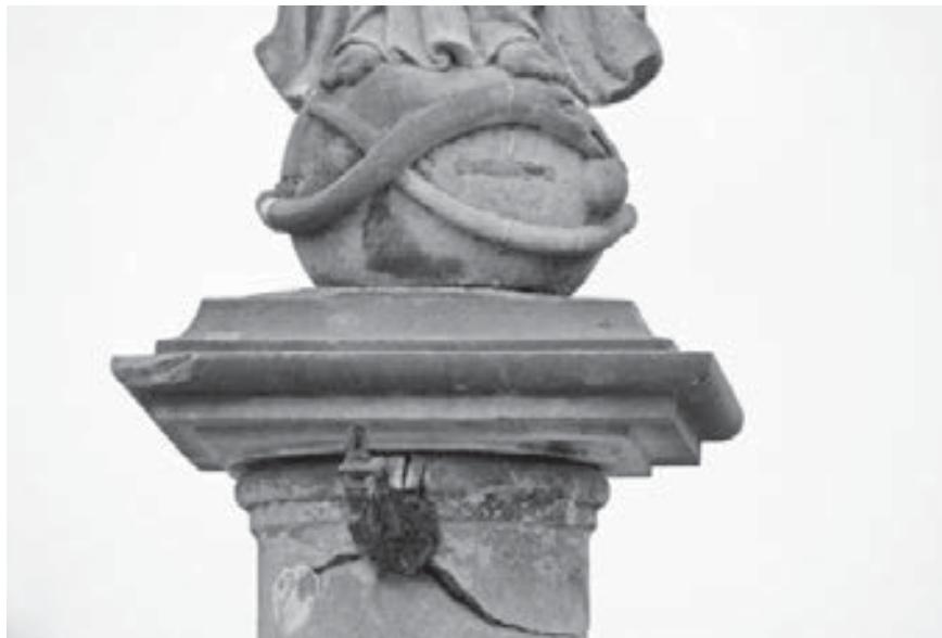
Detail poškození vrcholové části sloupu s prasklinou u lampy.
